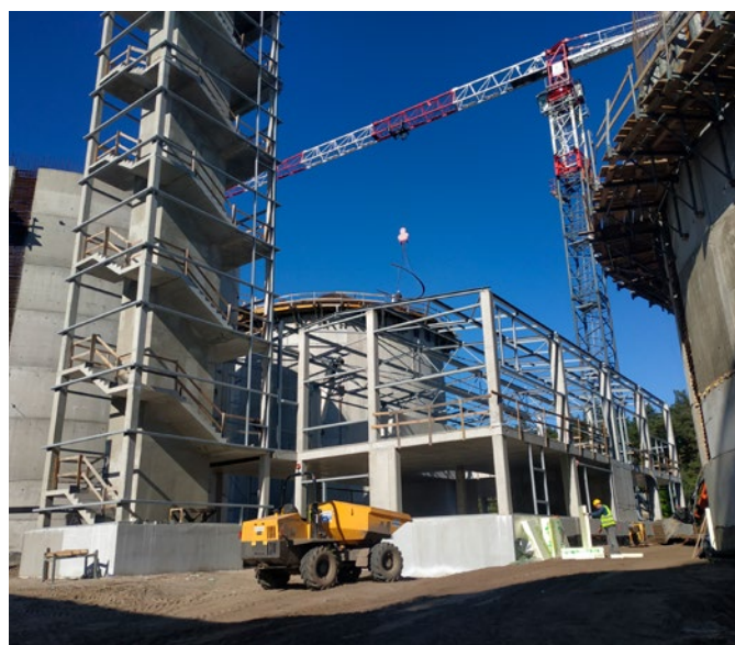
Fot. 12. Widok na komory fermentacyjne
