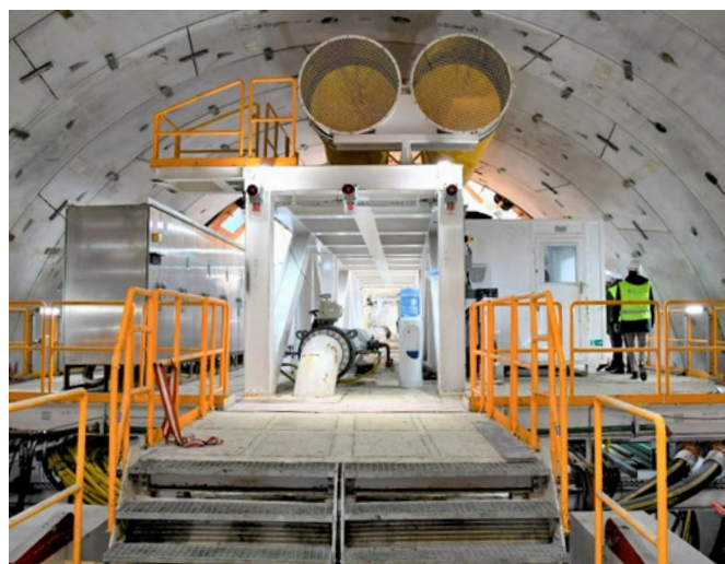
Fot. 6. Wnętrze TBM, po prawej stronie widoczna sterówka
