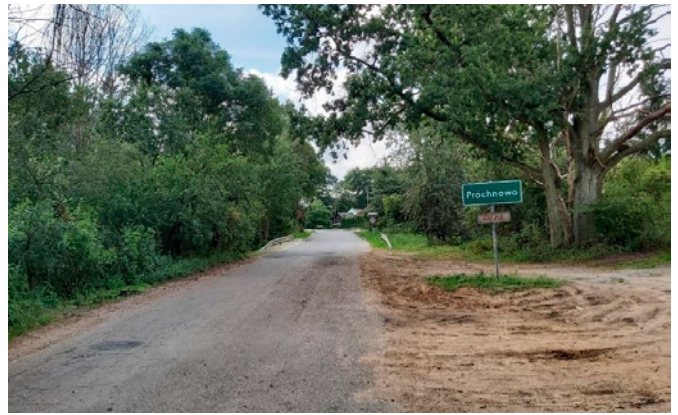
Fot. 14. Stan drogi powiatowej przed przebudową w miejscowości Próchnowo
